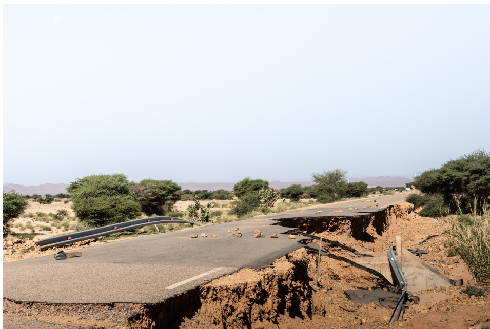
route détruite par le séisme
