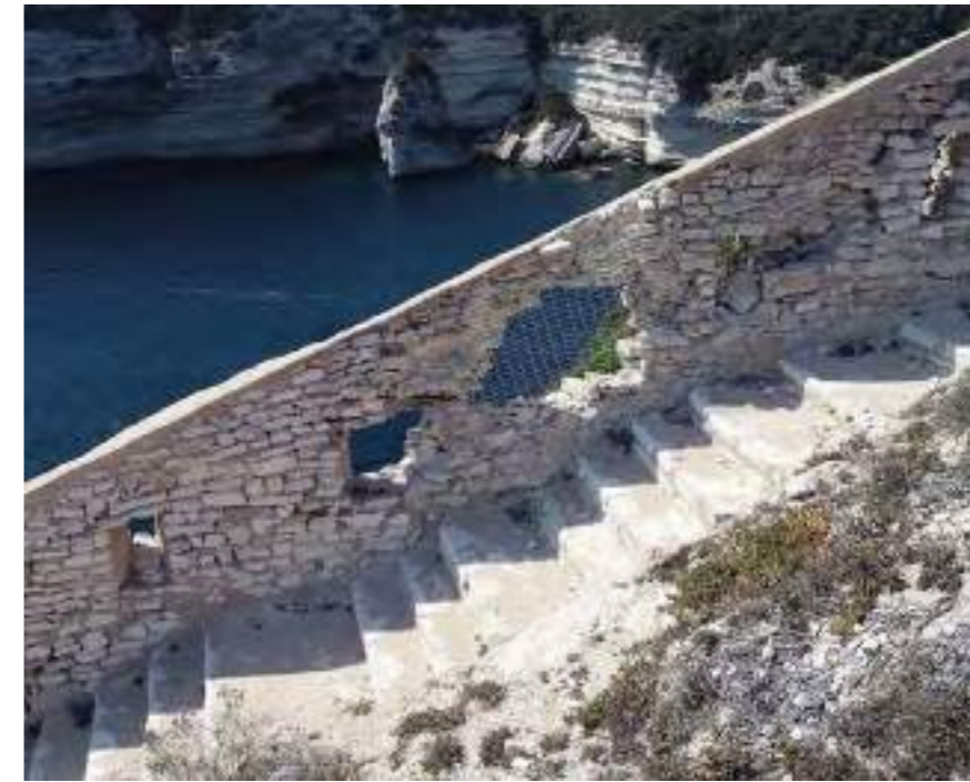
Mur d'enceinte de la batterie Saint-François avant restauration, 2020 Cl. Agence Pierre-Antoine Gatier
